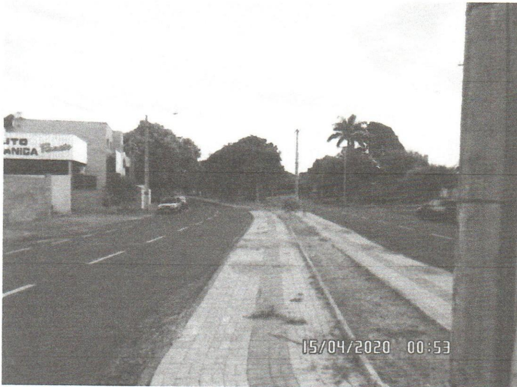
Execução de Pavimentação em lajota de concreto no canteiro central da Avenida Mangara entre a Rua Julio Quinaglia e Rua José Olico
