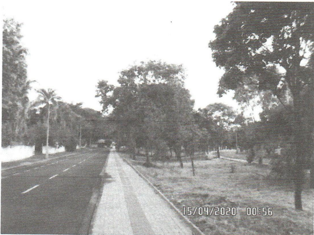
Execução de Pavimentação em lajota de concreto no canteiro central da Avenida Mangara entre a Rua José Olico e Rua Pedro Curti
