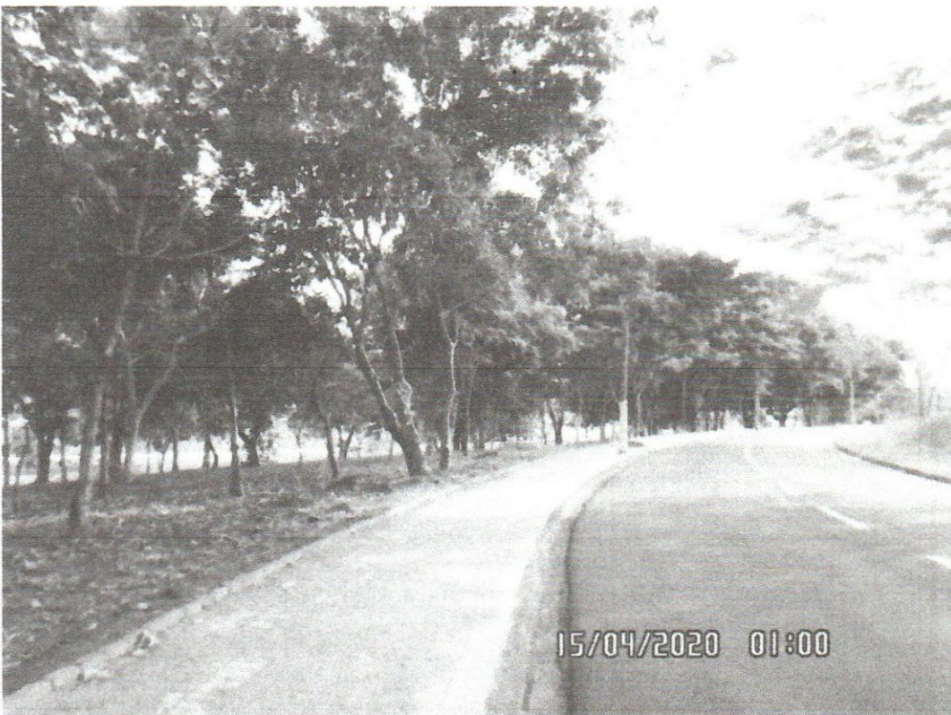
Execução de Pavimentação em lajota de concreto no canteiro central da Avenida Mangara entre a Rua Pedro Curti e Rua Filomena Tofaneli Bomfim
