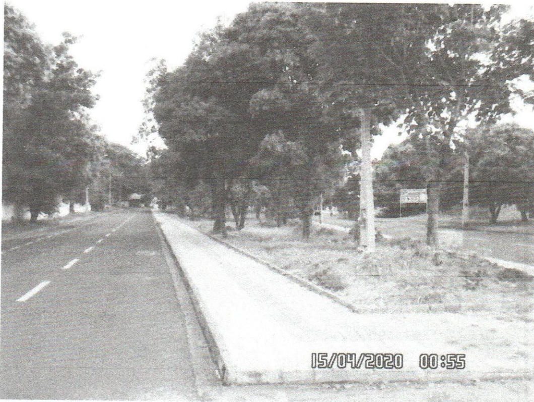
Execução de Pavimentação em lajota de concreto no canteiro central da Avenida Mangara entre a Rua José Olico e Rua Pedro Curti
