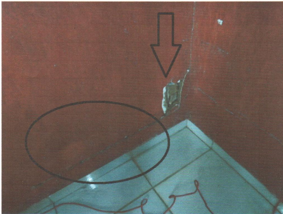
Foto 03: rachaduras na parte inferior da parede.
