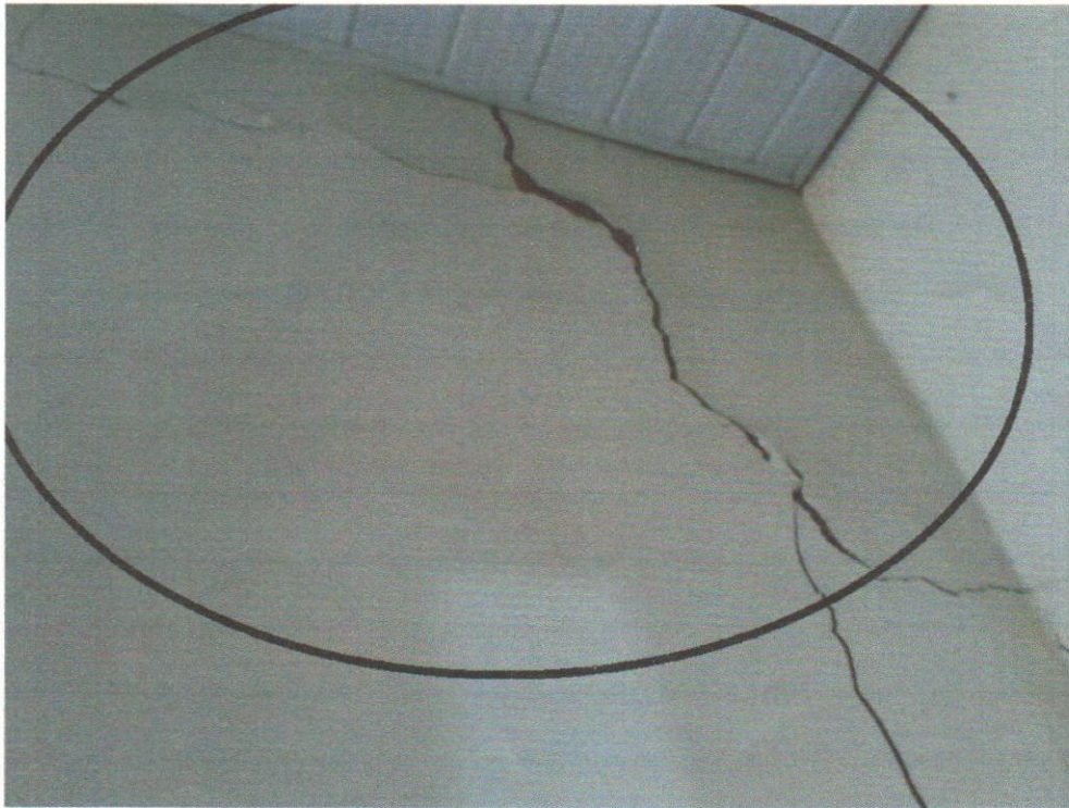
Foto 02: rachadura na parte interna da residência, evolução se comparada com foto 01.
