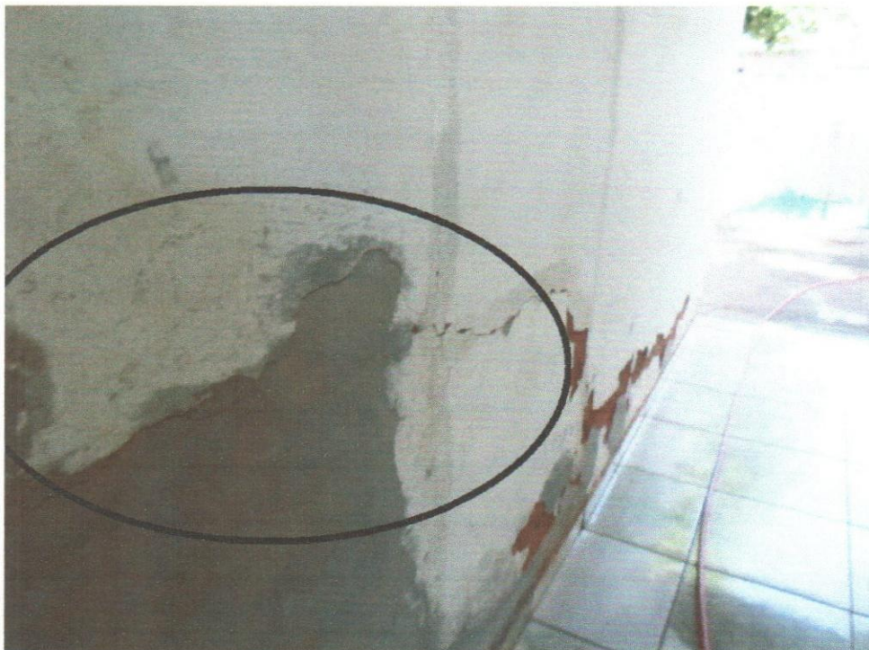
Foto 04: tentativas de corrigir a trinca com argamassa comum, sem sucesso.
